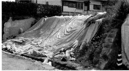
写真-1.2 ひな壇部分の変形・崩壊被害
