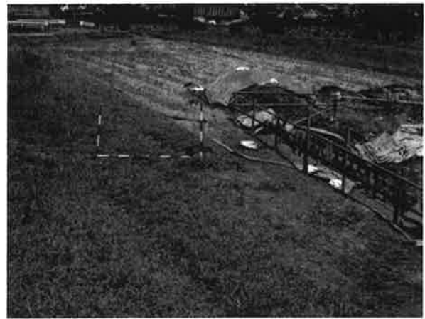
写真-29 踏査時に見られた断層変位
