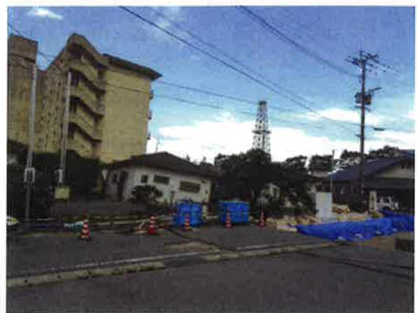
写真-6 A地点の陥没段差上に位置する家屋の傾き
