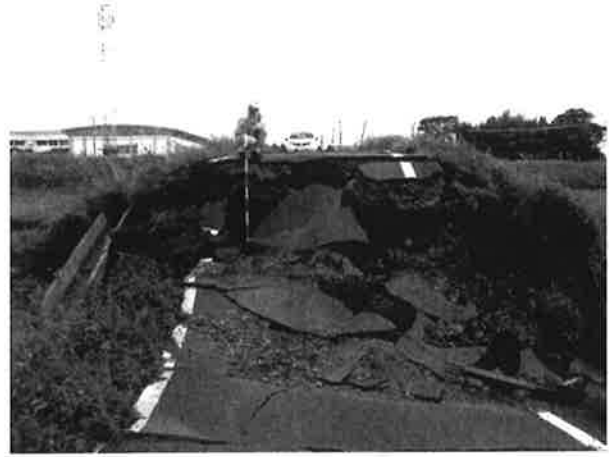
写真-19 D地点の鉄塔近くの陥没壁②
