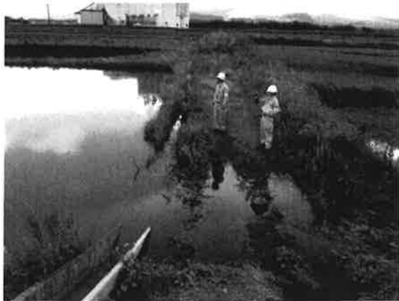
写真-12 C地点の農道の陥没
