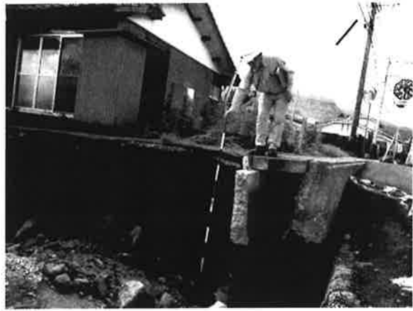
写真-8 B地点の南落ち1.5mに達する陥没崖
