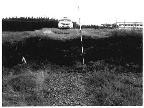
写真-17 D地点の農道に出現した陥没壁①
