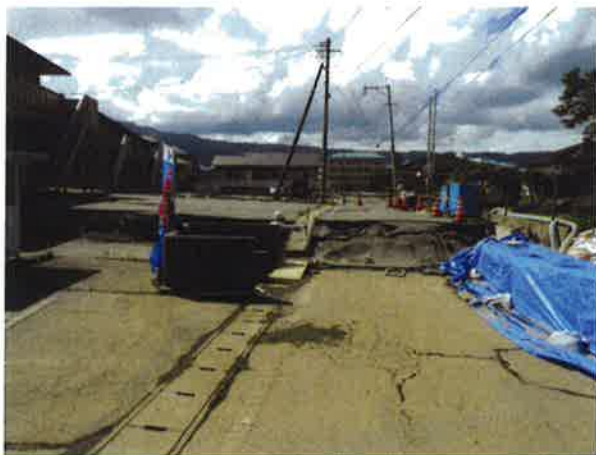
写真-5 A地点の道路の陥没(手前が陥没)
