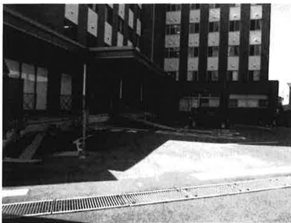
写真-39 液状化による駐車場の沈下(近見一丁目)
