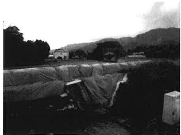
写真-15 陥没による家屋の傾倒（乙姫川左岸）
