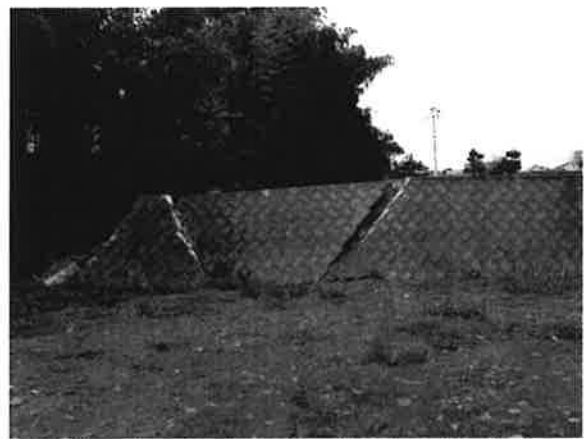
写真-38 ブロック積擁壁の被災(益城町)
