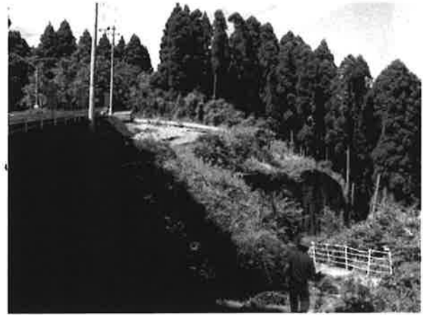
写真-21 ペンション村近くの道路被災
