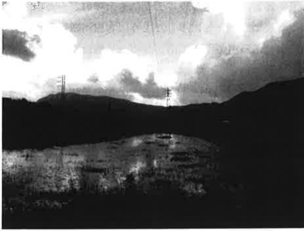
写真-16 D地点の陥没帯と傾倒した鉄塔
