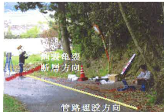
図-5.8 平田における道路面変状
