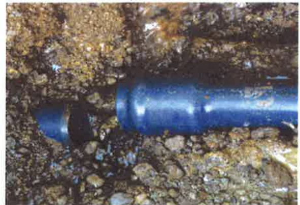
(h) HIPV-RR φ100 漏水 上陣
