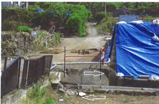
図-5.7 下陣の断層変位による道路面変状
