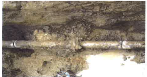
(f) K型DCIPφ100 漏水 下陣
