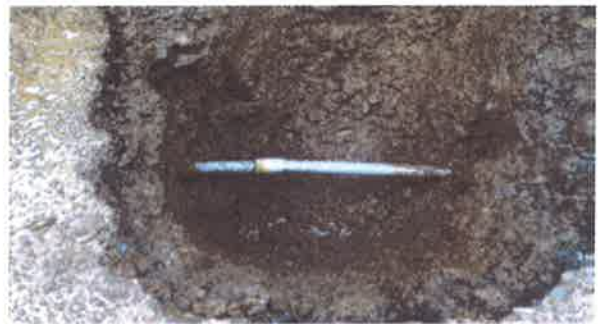
(d) 給水管漏水 小谷
