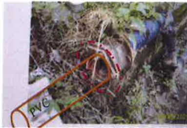
(d) 水道 DCIP と PVC の継手部破損
