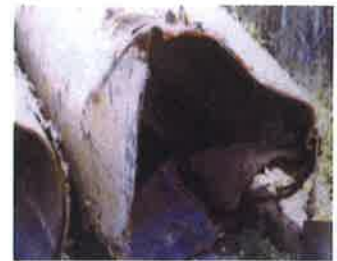
(f) 水道鋼管座屈
