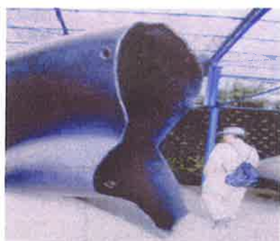
(a) 水道溶接鋼管座屈
