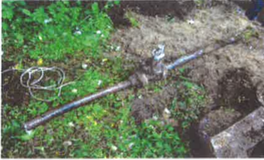
(a) 給水管バルブより漏水 管PEφ50 杉堂
