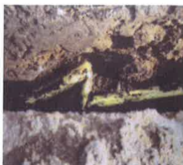
(b) ガス PE 管座屈
