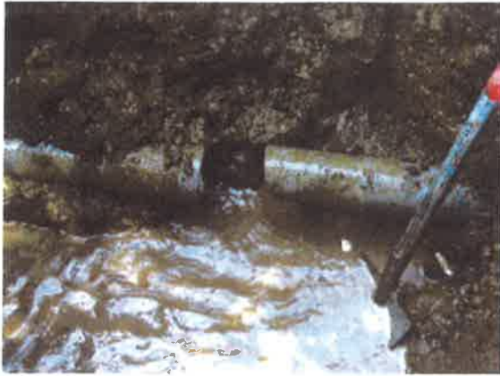
(i) PVC 抜け漏水 φ75 砥川
