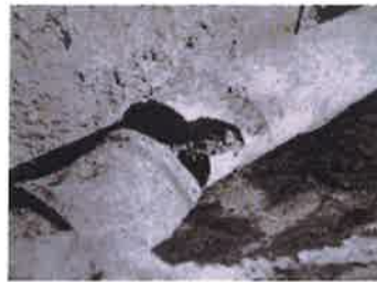
(e) 水道 CIP 継手破断
