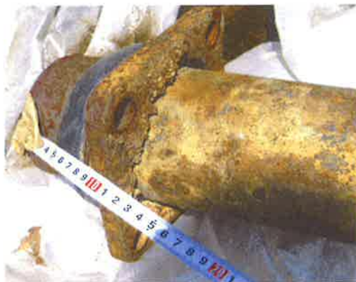
図-5.3 破壊管路の継手部（下陣）
