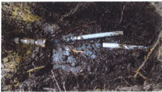
(e) 給水管 PVC φ20 漏水塩ビ管 小谷
