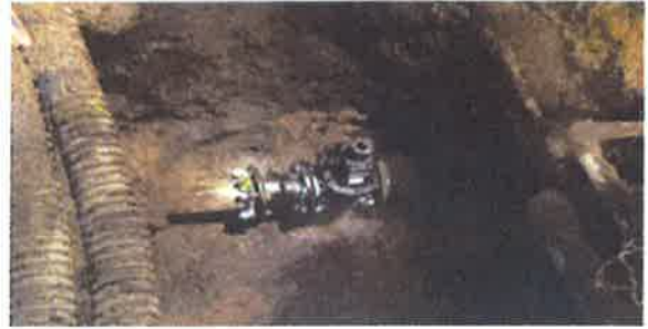
(b) 空港付近 φ150DCIP 仕切弁バルブ破損
