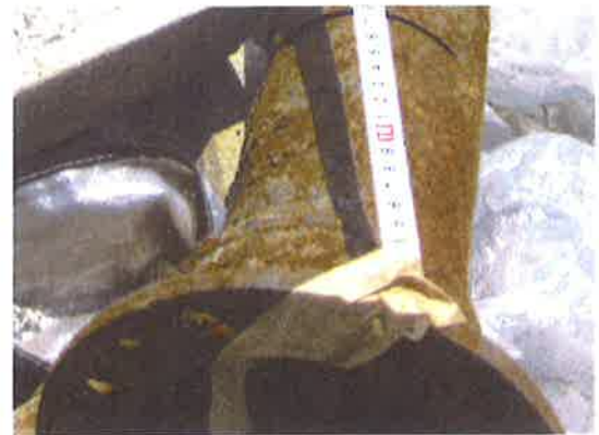
図-5.4 破壊管路の継手部（下陣）
