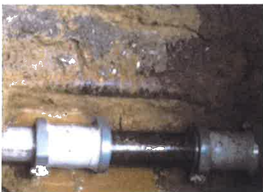
(g) HIPVφ150 送水 漏水(修理後) 下陣
