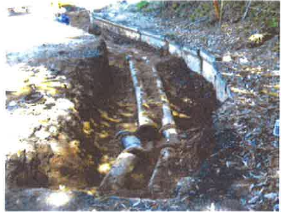
図-5.6 益城町平田の継手部破損
