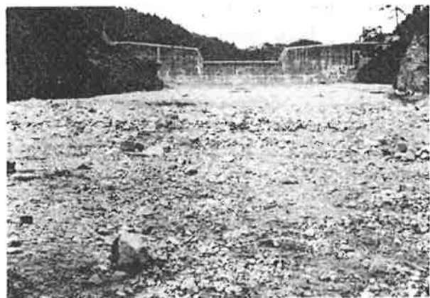
写真-9 1967年豪雨直後の五助堰堤の状況 26)
