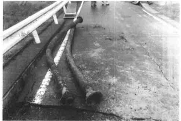
図-1 3 断層横断箇所では掘り起こされた DIP 管 14)
