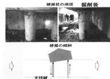
図-6 浄化センター建物杭の液状化破壊
