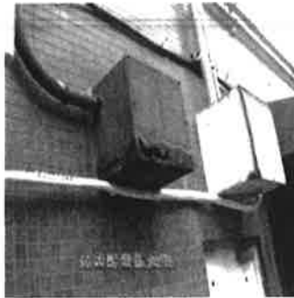
写真-2 危険なエアコン室外機
