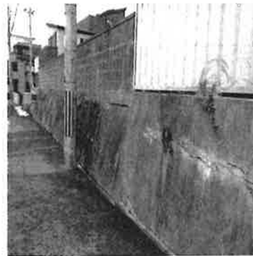
写真-5 擁壁クラック
