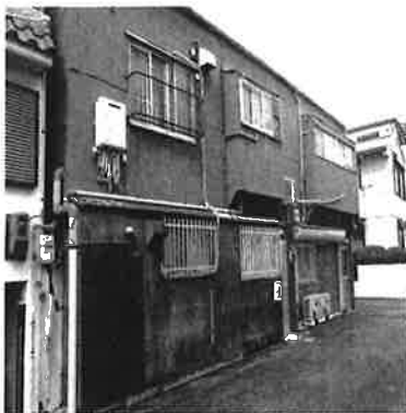
写真-4 倒壊危険家屋
