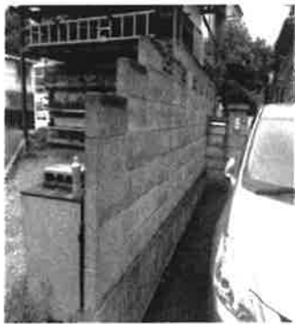
写真-7 違法駐車場ブロック塀
