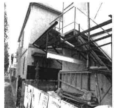
写真-6 落下危険階段
