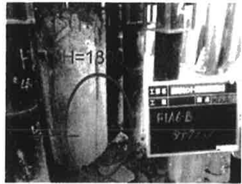
図-3.2(b) 杭頭破壊
