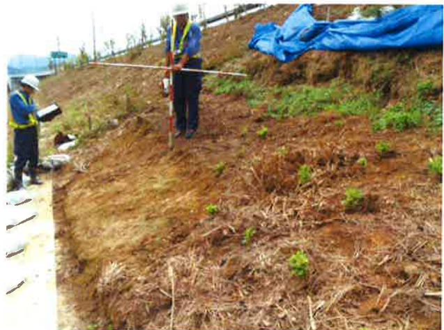
写真-2 当該盛土での表層崩壊の様子 （平成22年5月撮影）
