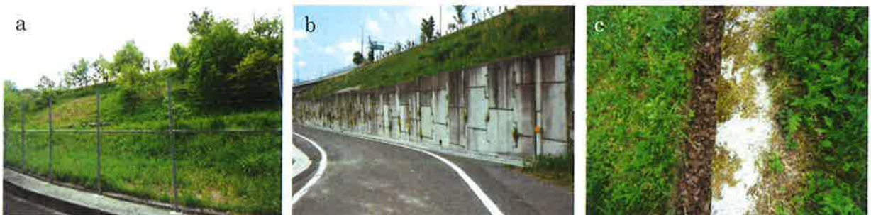
写真-1 当該盛土の様子（a：北側法面，b：南側擁壁部，c：北側法面の小段側溝に堆積した落葉や枯枝） 撮影位置は図-3に示す
